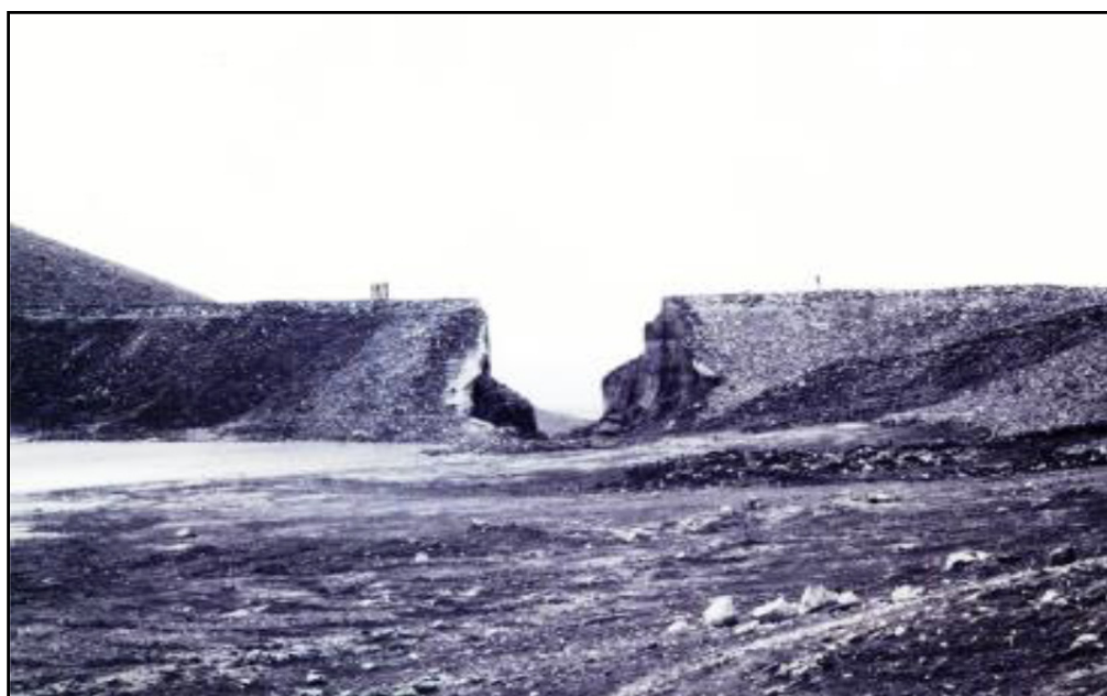
Рис. 6. Прорванное на всю высоту (9 м) тело плотины (фото В. Бойнагряна).
