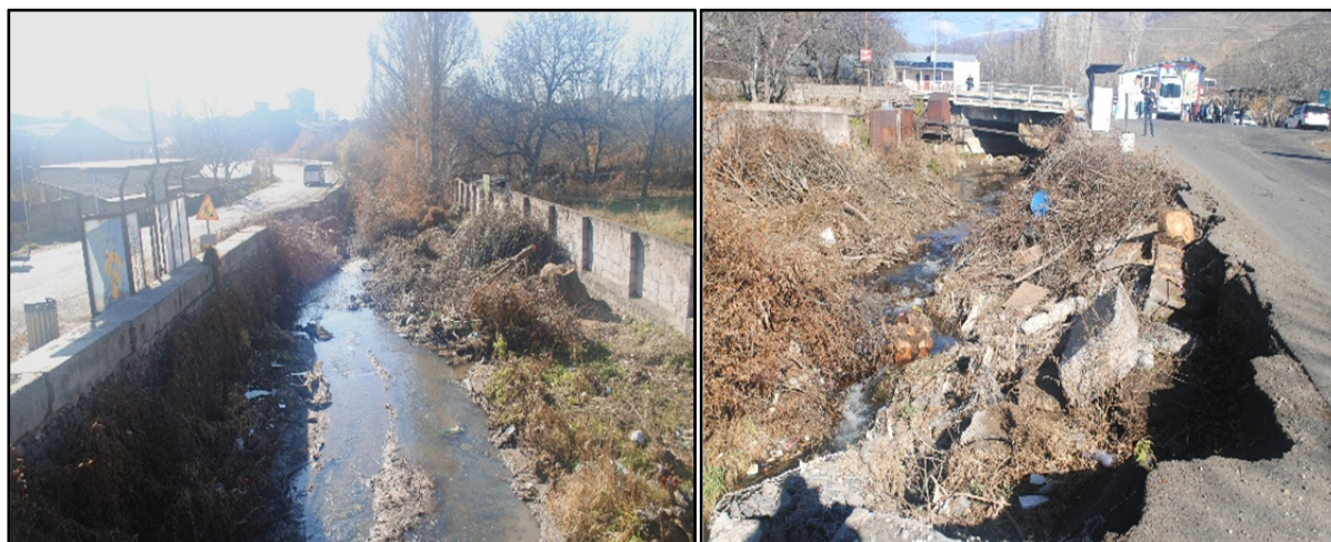
Рис. 6. Поврежденные селем участки автомобильной дороги в пределах села Арзакан (фото автора).
