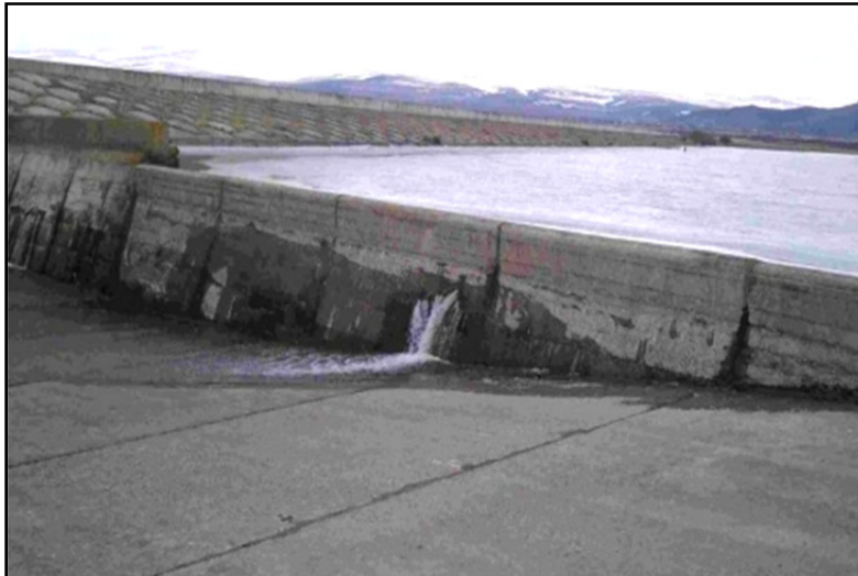
Рис. 10. Утечка воды через трещину в теле Мецаванской плотины (фото из Интернета).
