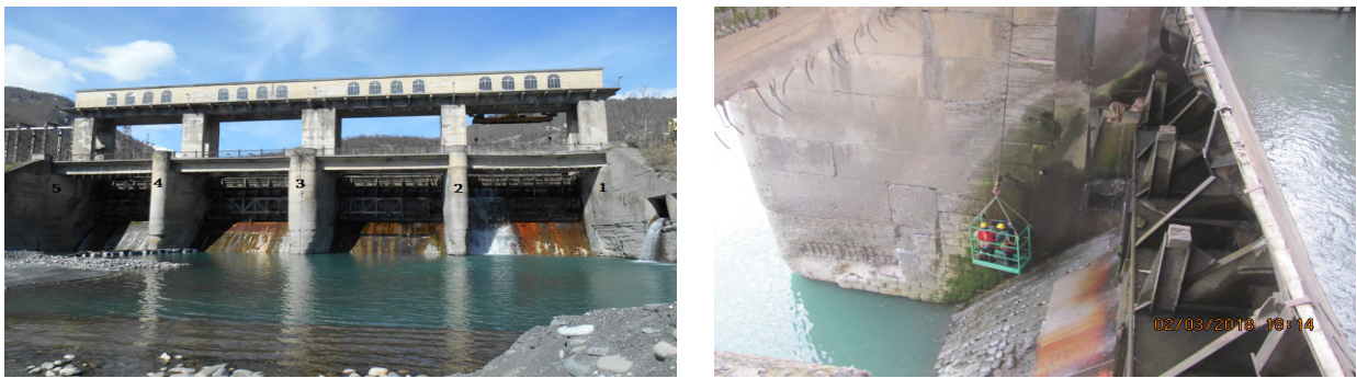
ნახ. 1. ა) ცაგერის წყალშემკრები. 1 – აღმოსავლეთი კედელი, 2 – პირველი (აღმოსავლეთი) ბურჯი, 3 – მეორე (ცენტრალური) ბურჯი, 4 – მესამე (დასავლეთი) ბურჯი და 5 – დასავლეთი კედელი. ბ) ულტრაბგერითი სამუშაოების ამსახველი სურათი წყალშემკრები აუზის კაშხლის მზიდ ბურჯებზე და კედლებზე.
